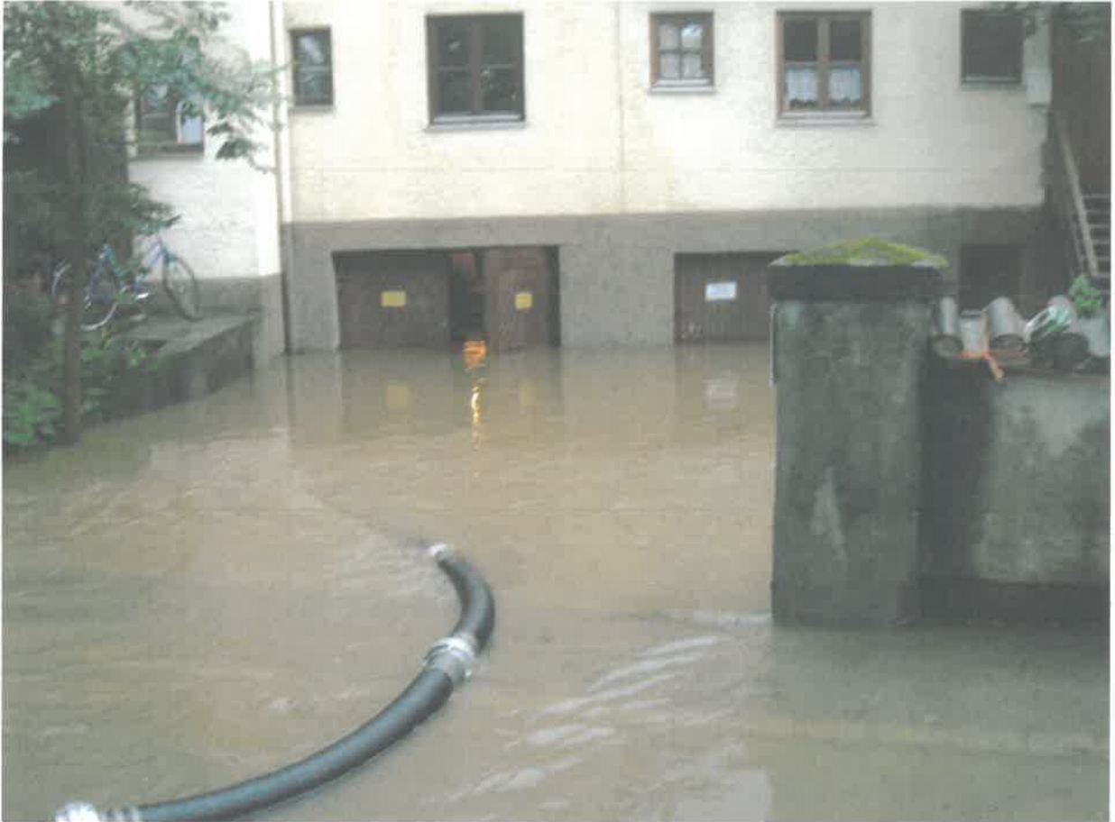
Bild Nr. 13, Schutzgut Wasser: Wasser im Keller in einigen Häusern der Krankenhausstraße
